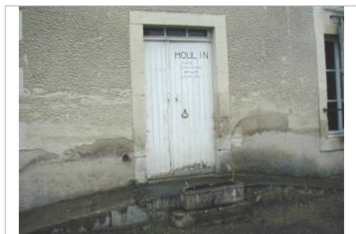
Niveau d'eau atteint le 27 avril 1998 (sommet de la dernière marche) - auteur photo : SOGREAH
