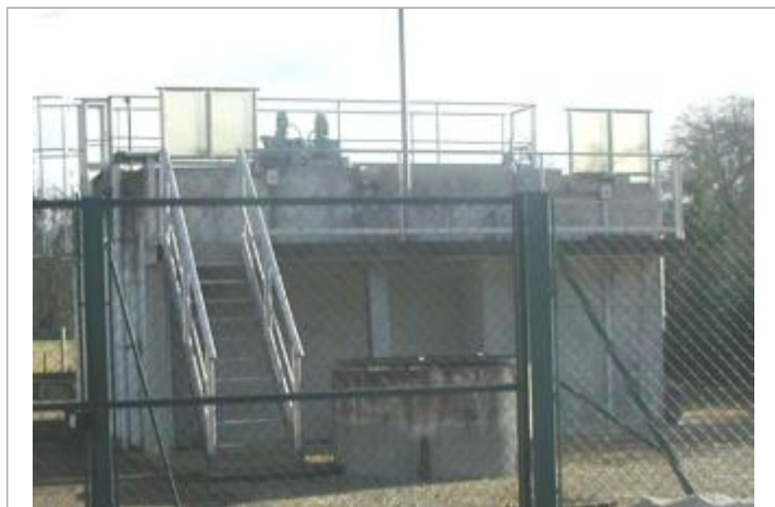
Puits de la station d'épuration inondée en 1998 - auteur photo : SOGREAH
