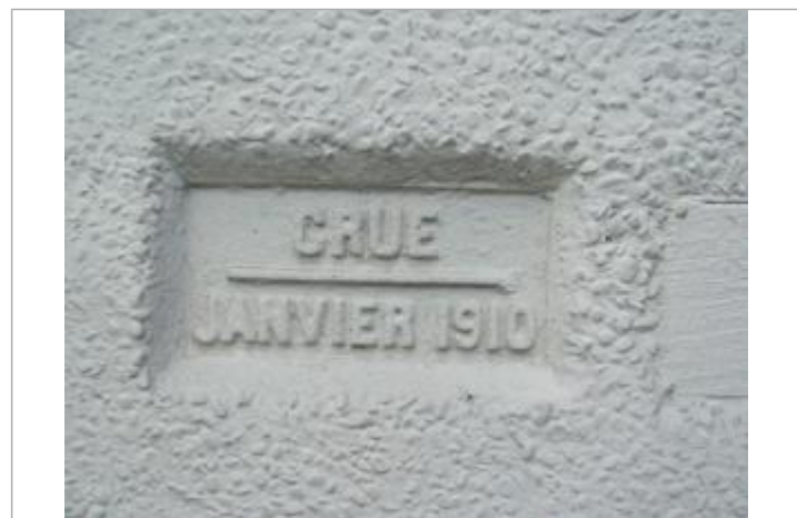
Repère de crue de 1910 - auteur photo : DIREN IDF
