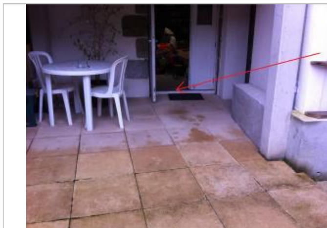
seuil de la porte de la cave (limite atteinte par l'inondation)
