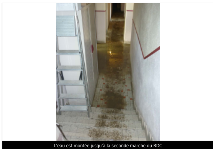
L'eau est montée jusqu'à la seconde marche du RDC
