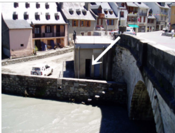
Trace de la crue à l'intérieur des toilettes
