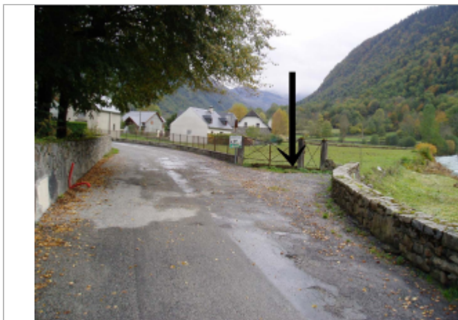
Débris dans le grillage
