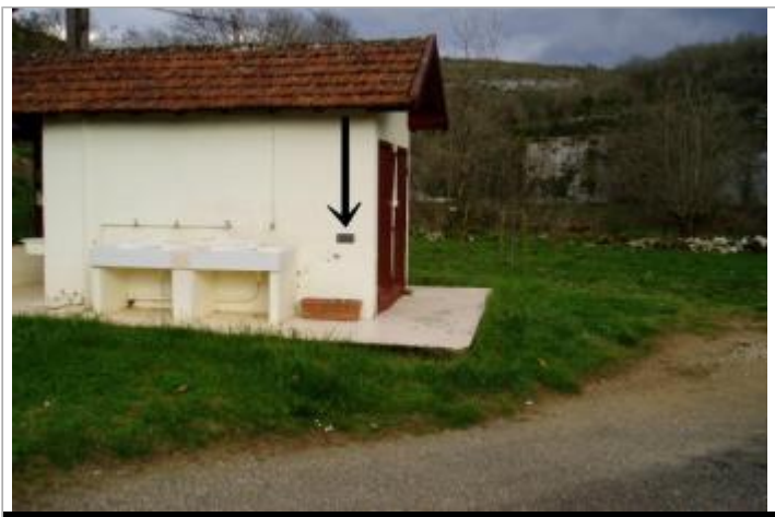
Ancien sanitaire du camping -DDT46
