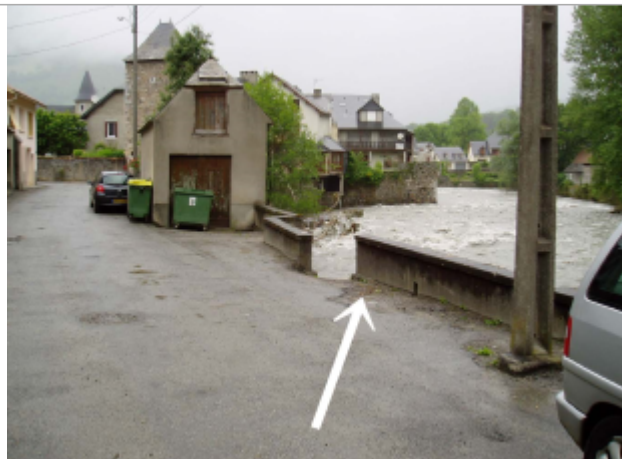
Débris montrant que la crue a frôlé à cet endroit le seuil de débordement
