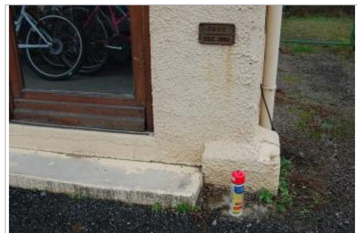
Vue de la laisse d'inondation - Auteur : GEOSPHAIR
