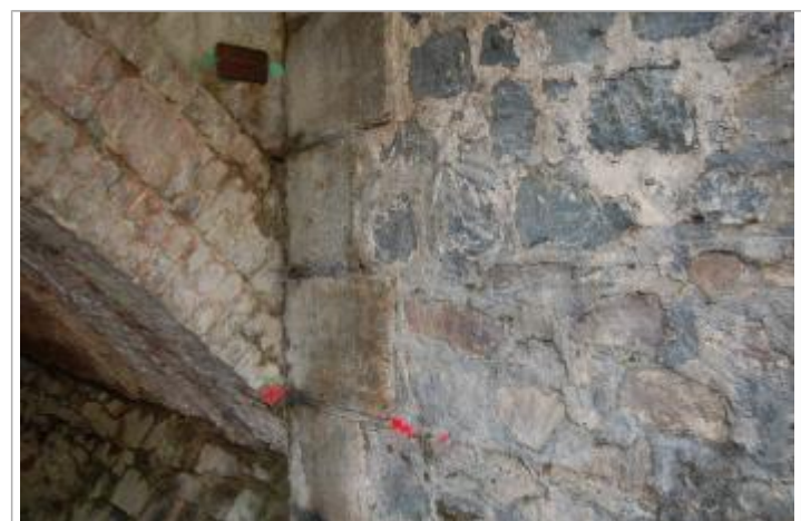
Vue de la laisse d'inondation - Auteur : GEOSPHAIR
