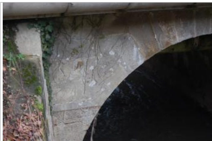
Vue de la laisse d'inondation - Auteur : GEOSPHAIR
