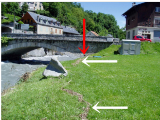
Laisse de crue
