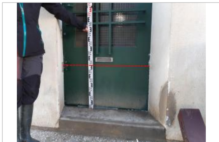
Laisse d'inondation sur la porte d'entrée
