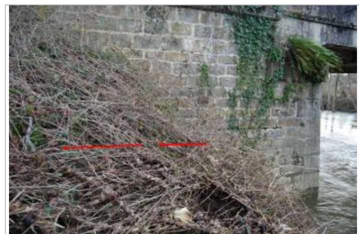
Vue de la laisse d'inondation - Auteur : GEOSPHAIR
