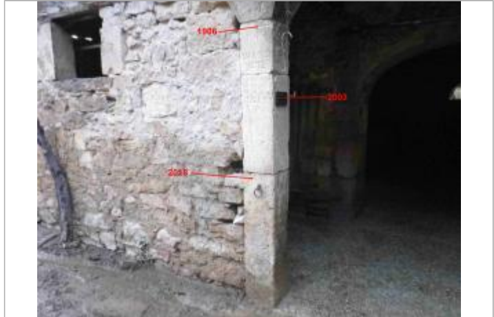
Vue de la laisse d'inondation - Auteur : GEOSPHAIR
