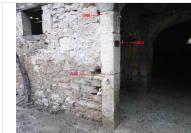
Vue de la laisse d'inondation - Auteur : GEOSPHAIR
