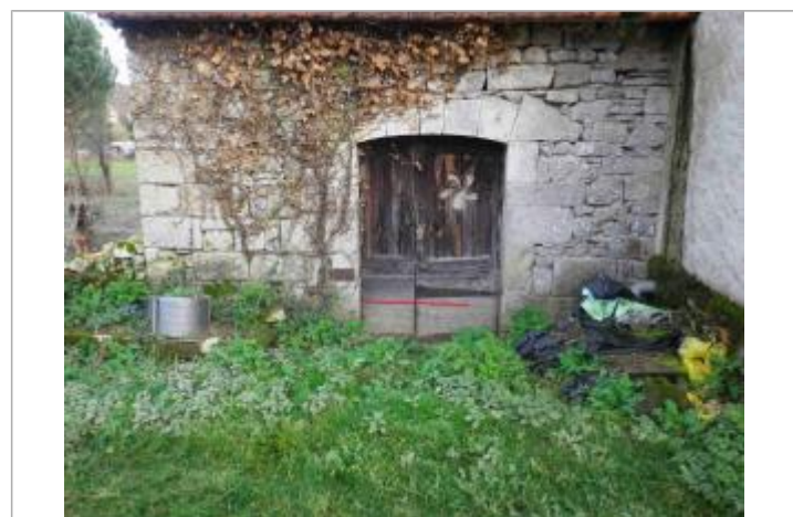
Vue de la laisse d'inondation - Auteur : GEOSPHAIR
