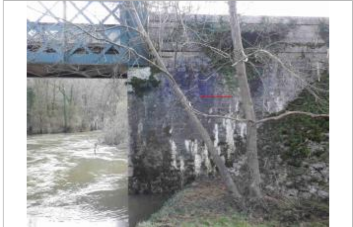
Vue de la laisse d'inondation - Auteur : GEOSPHAIR
