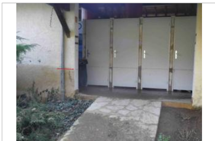
Vue de la laisse d'inondation - Auteur : GEOSPHAIR
