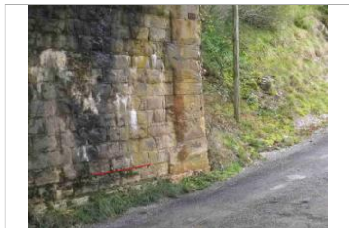
Vue de la laisse d'inondation - Auteur : GEOSPHAIR
