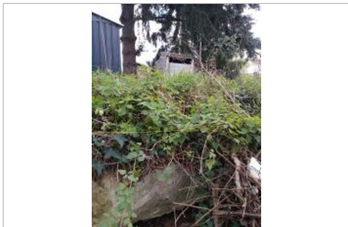
laisses de crue côté rivière - environ 15cm sous la crête du merlon
