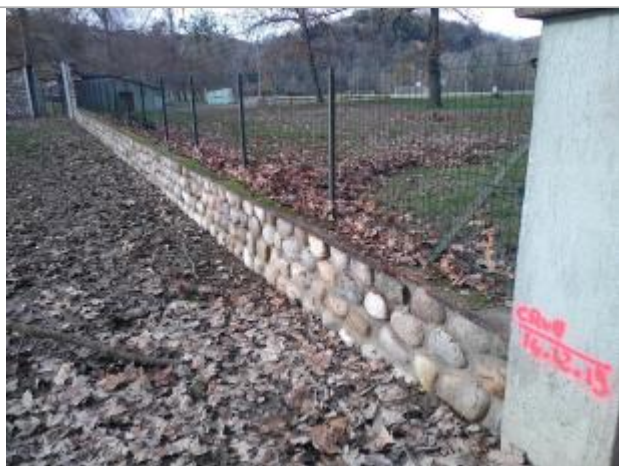
Hauteur atteinte au niveau du haut du muret de clôture
