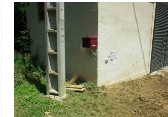
Vue de la laisse d'inondation - Auteur : GEOSPHAIR
