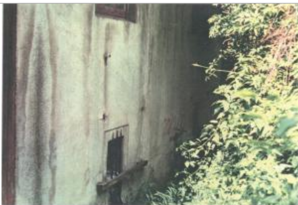
(24172) Commune de Mauzac (RG) : Ancien moulin Loisse de crues de 1971 (172,77 mNGF) à l'extérieur
