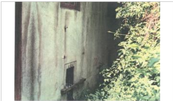
(24172) Commune de Mauzac (RG) : Ancien moulin Lois de crues de 1971 (172,77 mNGF) à l'extérieur
