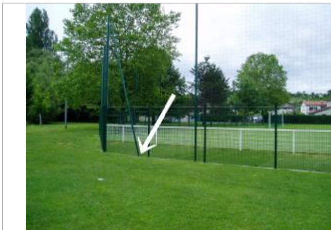
Vue vers l'aval. Sur des poteaux du grillage la crue a déposé une trace de boue.
