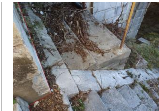
Débris végétaux sur les marches du pont ©Survey
