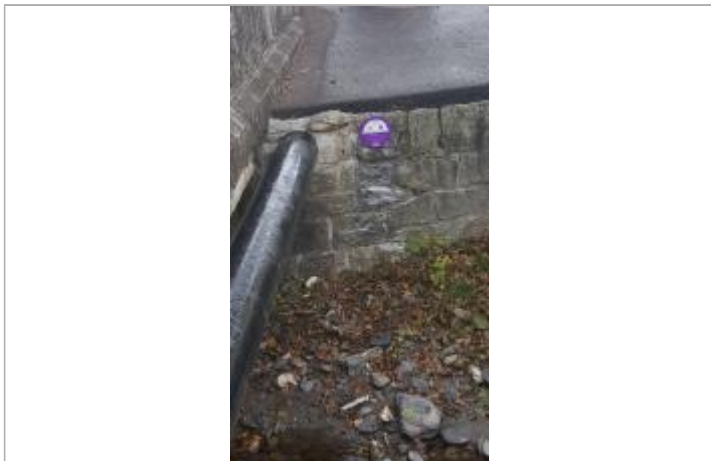
crue du 13 janvier 2004
