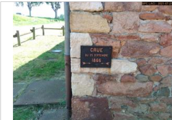
Plaque noire sur angle du bâtiment côté canal à proximité d'une gouttière grise
