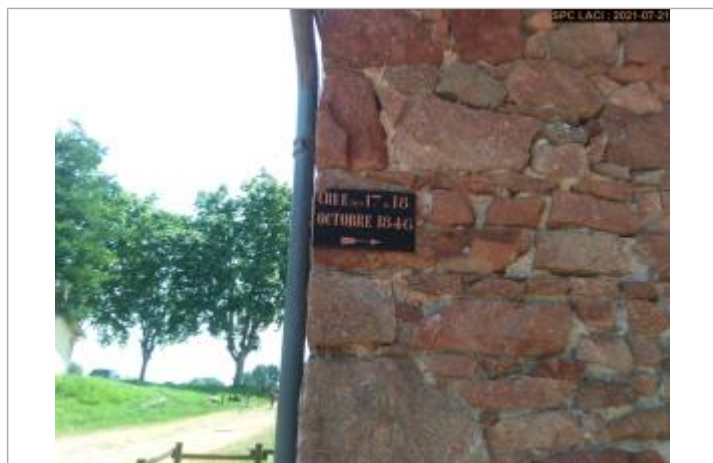
Plaque noire sur le mur du bâtiment côté canal à proximité de la gouttière
