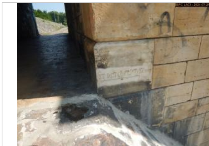
Sur le mur du coin du pilier du pont SNCF à 30cm du sol et à proximité de la Loire
