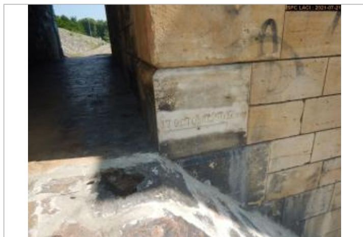
Sur le mur du coin du pilier du pont SNCF à 30cm du sol et à proximité de la Loire
