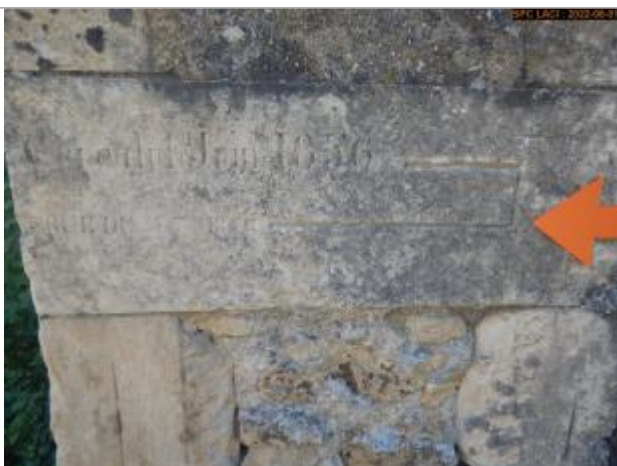
Vue du repère éloignée (côté angle mur)
