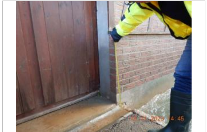
Debordement de cours d'eau
