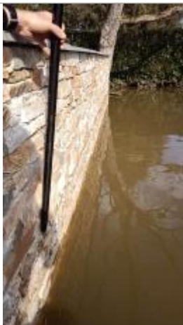
Vue sur la laisse d'inondation et le point de mesure
