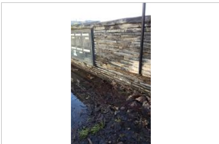
Vue sur la laisse d'inondation et le point de mesure
