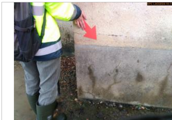
Vue sur la laisse d'inondation
