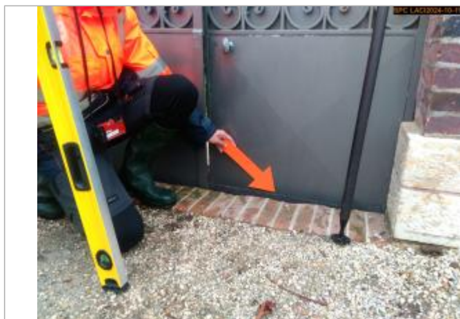
Vue sur la laisse d'inondation
