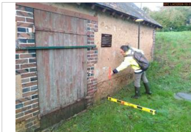
Vue sur la laisse d'inondation
