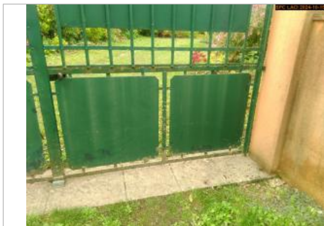
Vue sur la laisse d'inondation
