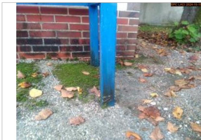
Vue sur la laisse d'inondation
