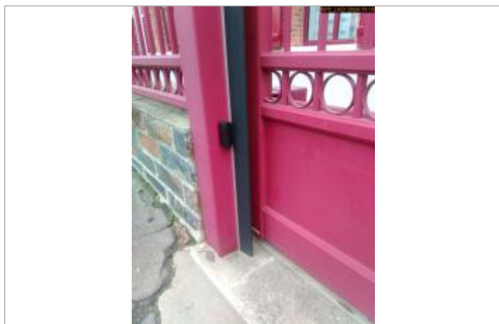
Vue sur la laisse d'inondation
