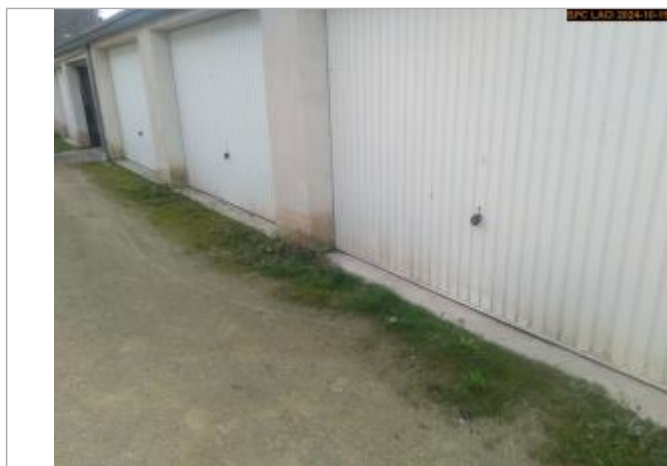
Vue sur la laisse d'inondation
