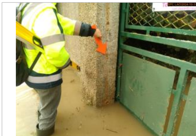
Vue sur la laisse d'inondation
