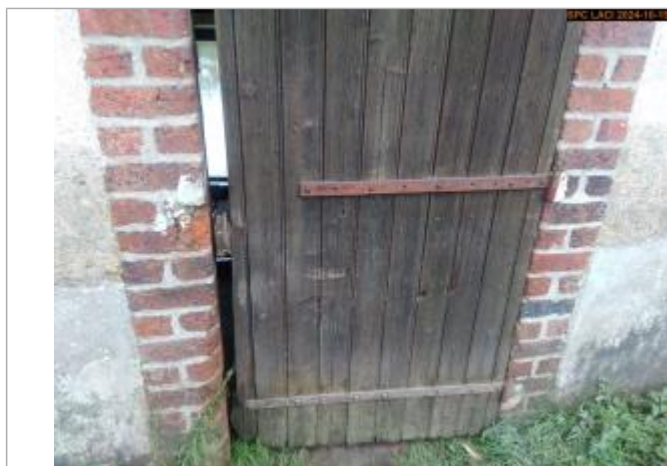
Vue sur la laisse d'inondation
