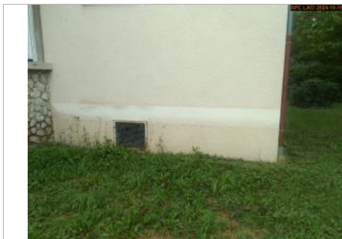
Vue sur la laisse d'inondation
