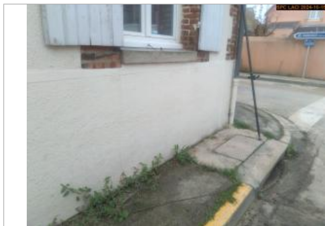
Vue sur la laisse d'inondation
