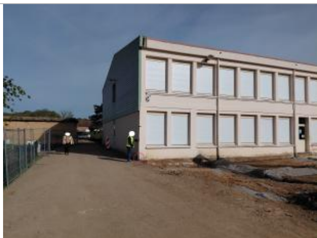
Laisse de crue au pied du bâtiment.
