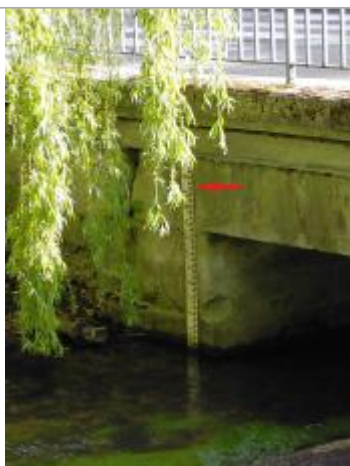
L'eau est montée au niveau 1.44 m de l'échelle.
