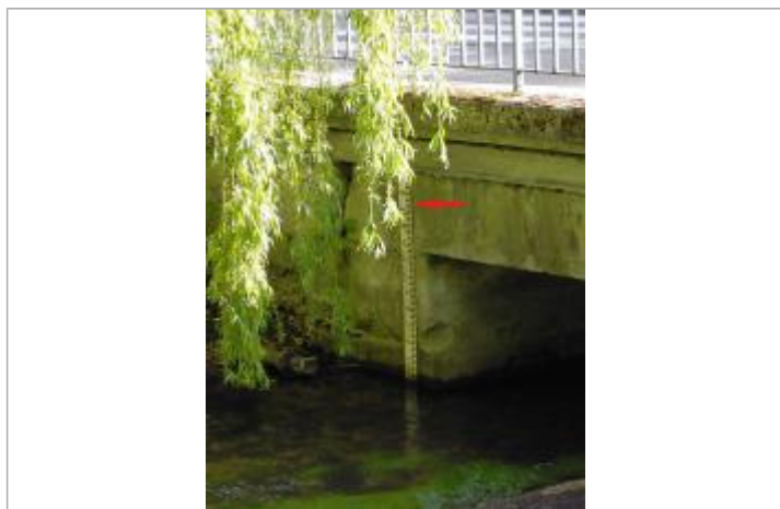
L'eau est montée au niveau 1.44 m de l'échelle.
