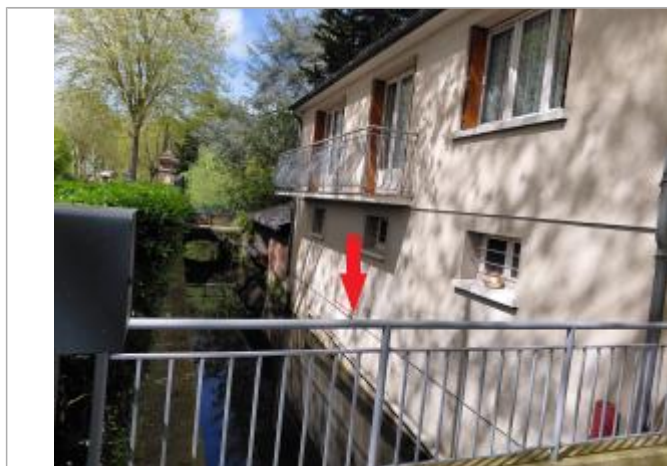
Laisse de crue sur la façade.
