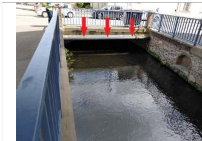
Laisse de crue au niveau de la canalisation noire.
